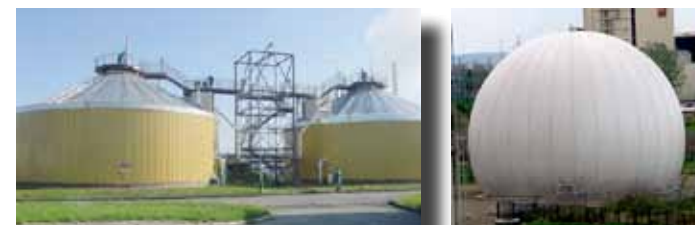
Wydzielone komory fermentacyjne MPWiK Rzeszów Zbiornik na biogaz MPWiK Rzeszów
