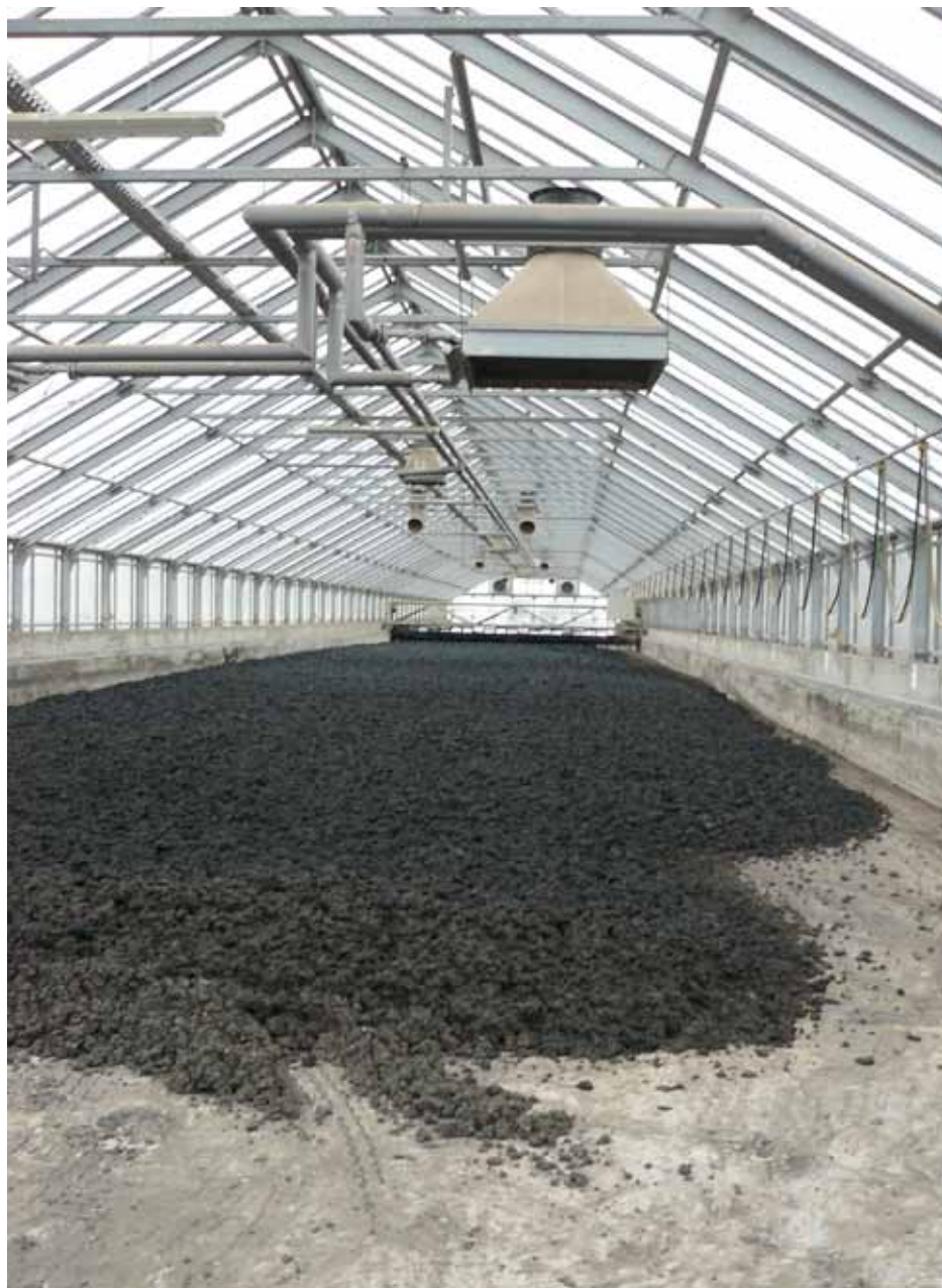
Suszarnia słoneczna przefermentowanych osadów ściekowych Miejskiego Przedsiębiorstwa Wodociągów i Kanalizacji w Rzeszowie
